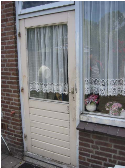
Achterstallig onderhoud aan het schilderwerk van de houten kozijnen.
