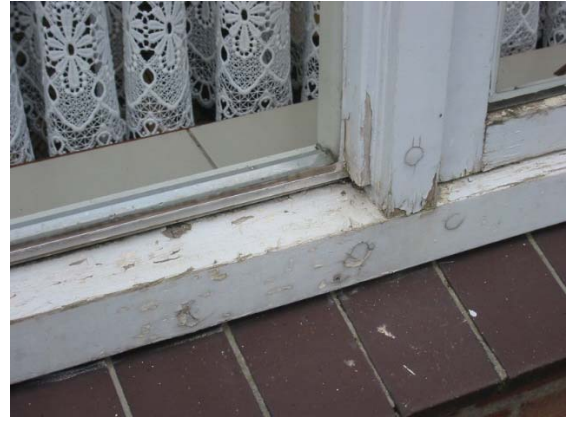
Achterstallig onderhoud aan het schilderwerk van de houten kozijnen.
