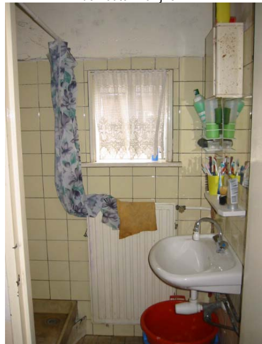
De douche is toe aan een grote onderhoudsbeurt.
