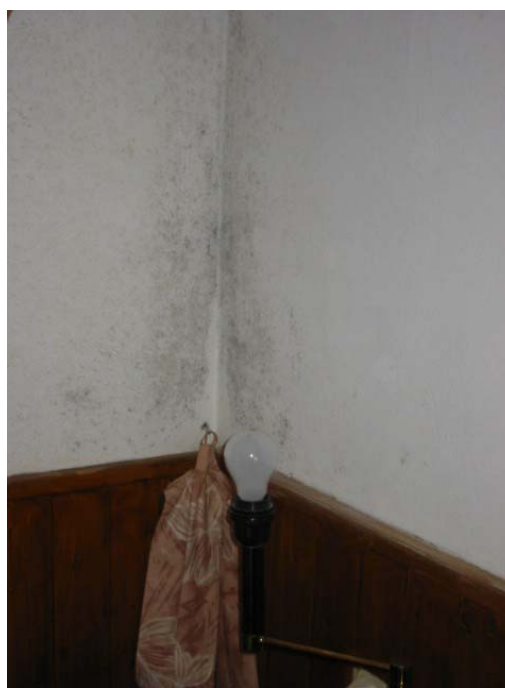
Schimmelvorming op binnen spouwblad van de kopgevel door het doorslaan van vocht.
