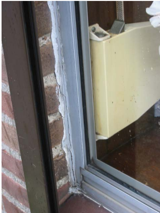
De kitvoegen van de aluminium kozijnen zijn verouderd
