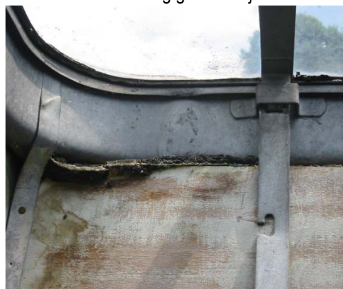
De aansluitrubbers van het daklicht zijn verouderd en moeten vervangen worden door de verhuurder.
