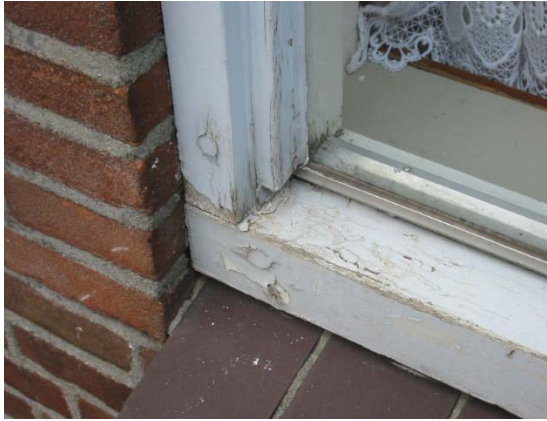
Achterstallig onderhoud aan het schilderwerk van de houten kozijnen.
