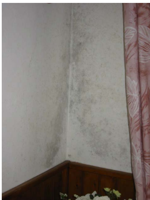
Schimmelvorming op binnen spouwblad van de kopgevel door het doorslaan van vocht.
