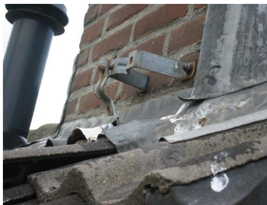
Het zinkwerk bij de schoorsteen moet door de verhuurder nagelopen worden.
