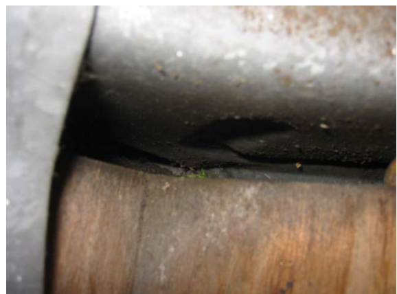
De aansluitrubbers van het daklicht zijn verouderd en moeten vervangen worden door de verhuurder.
